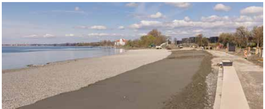
Das verbaute Bodenseeufer in Bregenz wurde durch die Renaturierung in ein ökologisch wertvolles Flachufer verwandelt. Die Bilder zeigen den Bauabschnitt bis zum Strandbad Lochau im Oktober 2022 (oben) und März 2023 (unten). (Bild: Land Vorarlberg)
